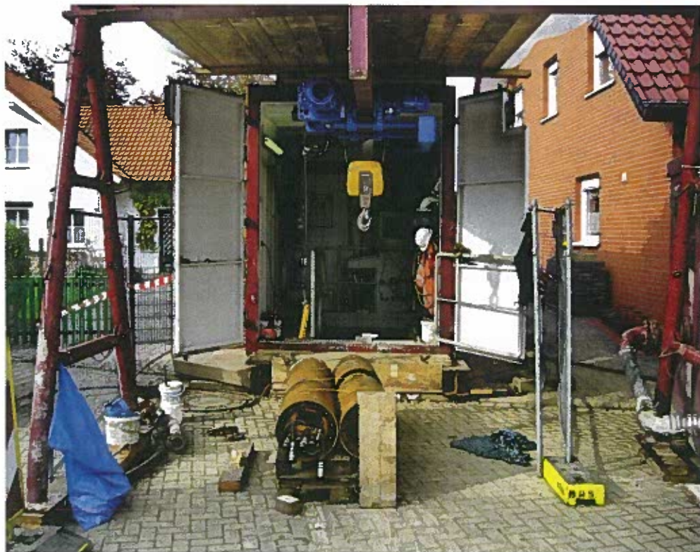
Bild 1: Aufgrund der örtlichen Rahmenbedingungen musste der Pressschart für den Rohrvortrieb auf einem Privatgrundstück abgeteuft werden
